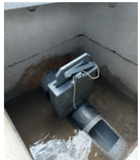
Vue d'un des 2 regards de vanne guillotine
